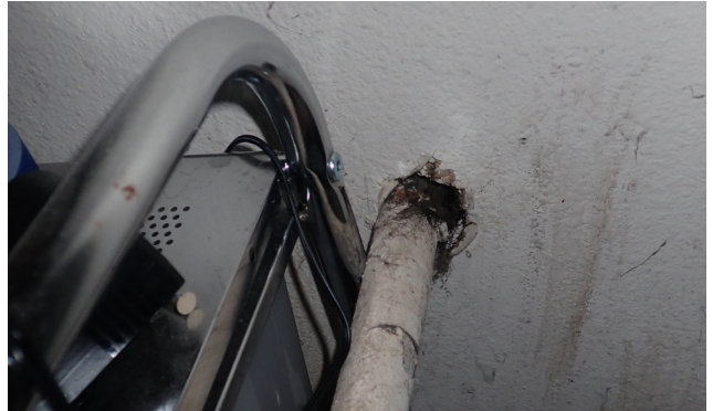
INFILTRACIÓN EN EL GARAJE
